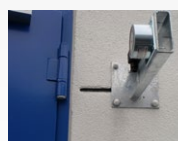
Türfeststellanlage mit Schließfolgeregler
